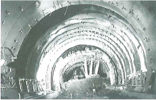
FIG. 5 Tunnel San Stefano : effondrement de la cavité. San Stefano tunnel : collapse of the cavity.
