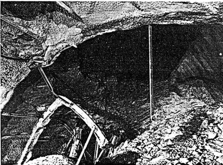
Fig. 8. Details of destroyed ribs Ausschnitte des zerstörten Ausbaues
