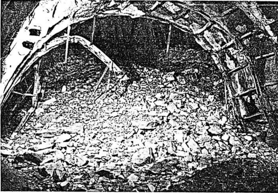
Fig. 7. Heading in the burst area Tunnelbrust im Vortrieb
