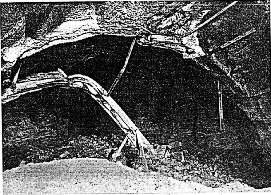
Fig. 9. Details of destroyed ribs; on the background, fault plane with marked oxidation traces Ausschnitte des zerstörten Ausbaues; im Hintergrund sieht man die Glättung der Störung mit Oxydationsspuren
