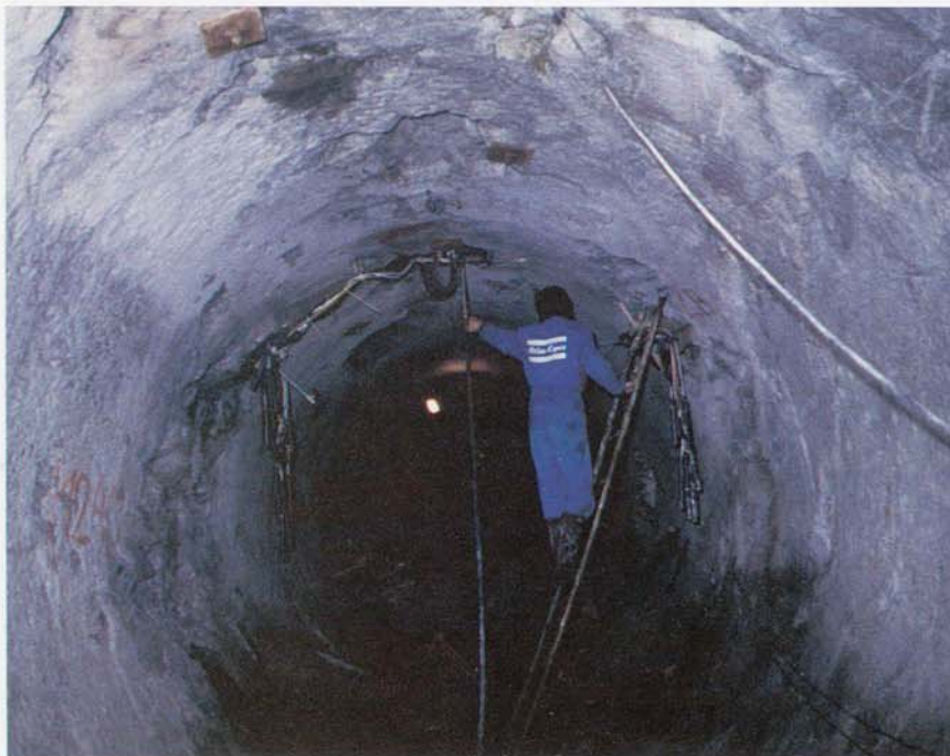
Foto 17 - Foro Pilota Galleria FS Prato Tires, Ponte Gardena (1985) - Messa in opera degli estensimetri «recuperabili».
