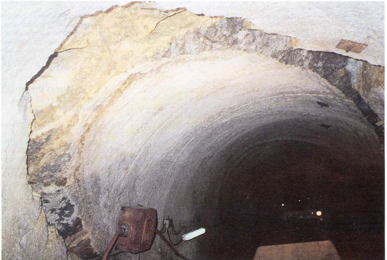
Foto 12 - Foro Pilota Galleria FS Malborghetto (1986) - Grossa discontinuità riempita con materiale plastico.
