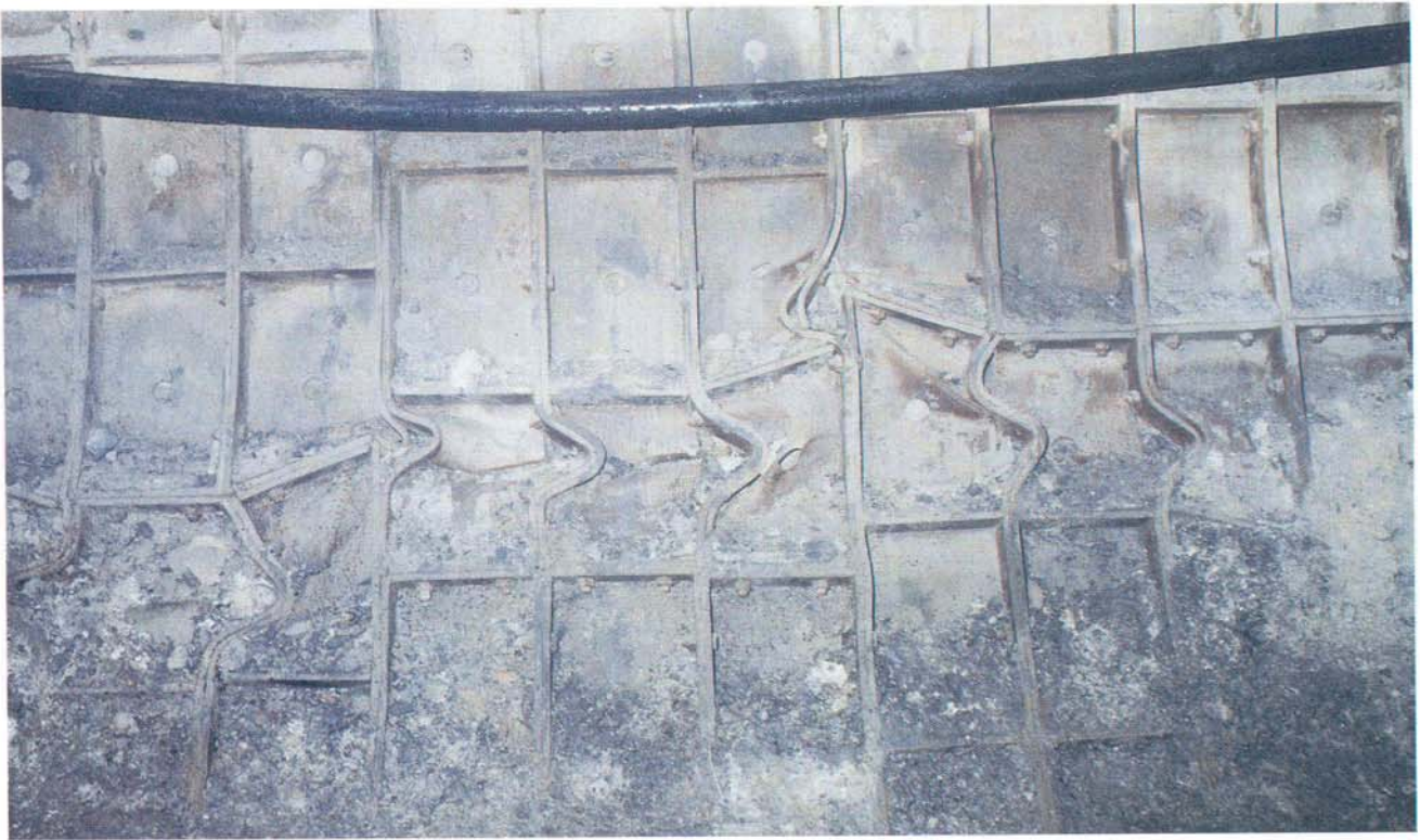
Foto 16 - Foro Pilota Galleria Fs Malborghetto (1986) - Forti deformazioni della blindatura per spinte elevate.
