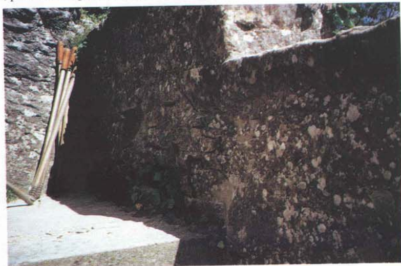
Foto 3 Fessurazioni nel muretto sovrastante il «Precipizio»
