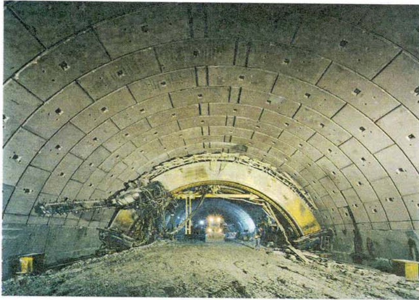
▲ FOTO 1 - Macchina per l'esecuzione del pretaglio meccanico e l'assemblaggio della «volta attiva»
