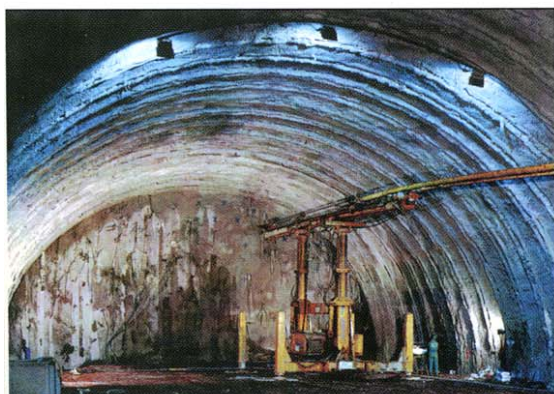
Foto 3: Galleria dell'Appia Antica: fase di consolidamento del fronte mediante elementi strutturali di vetroresina
