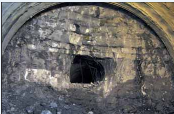
Figura 13 - La sezione tipo B0 (formazione di arenarie del Monte Cervarola) presso l'imbocco lato Bologna
