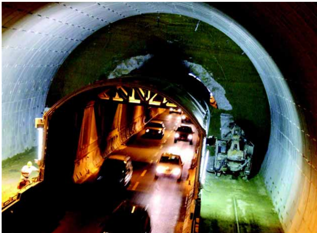
Fig. 18 – Galleria Nazzano: il flusso veicolare che scorre sotto lo scudo di protezione del traffico durante le lavorazioni di allargamento della galleria.
