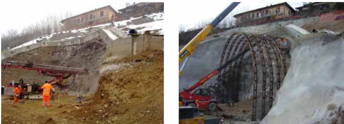
Figura 19. Le fasi esecutive: scavi di ribasso, esecuzione dei trattamenti al fronte e getto della dima
