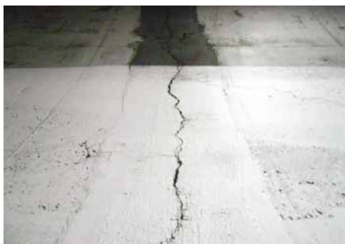
13A e 13B. La fessura longitudinale (13A) e verifica con carotaggio (13B)
