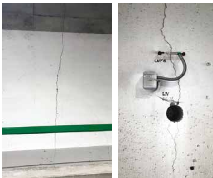
11A e 11B. Alcune fessure verticali monitorate
